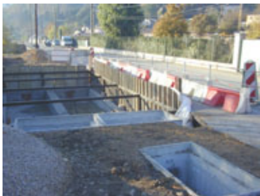
Exemple de chambre de jonction
